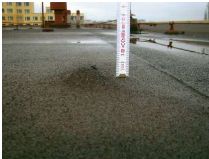
Obrázek 11 - Vypouklina v asfaltovém pásu [28]
