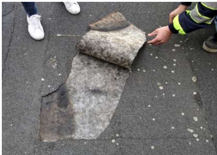
Obrázek 10 - Separace vrstvy asfaltového pásu [27]
