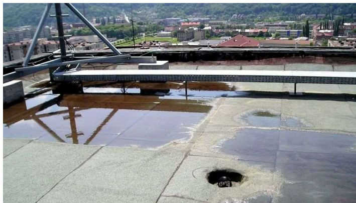
Obrázek 2 - Louže na střeše [3]
