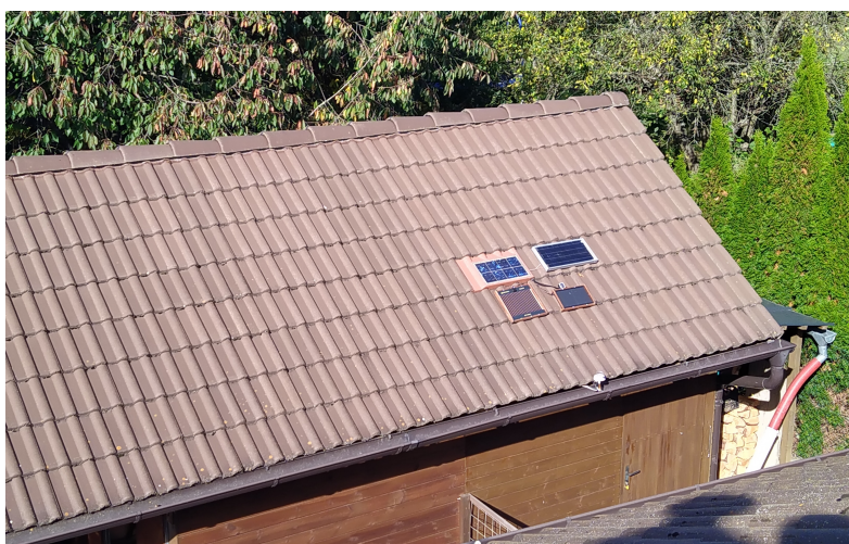
Obrázek 3.1: Pohled na modelovou instalaci
