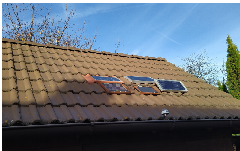
Obrázek 3.10: Zastínění panelů přecházejícím stínem komínu
