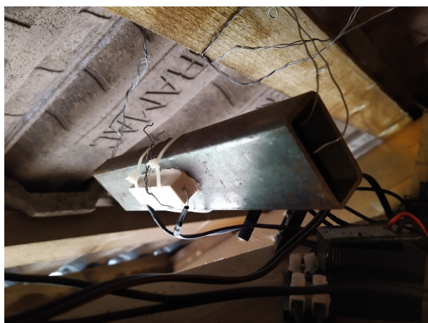
Obrázek 3.14: Zavěšení mařícího rezistoru s improvizovaným chladičem
