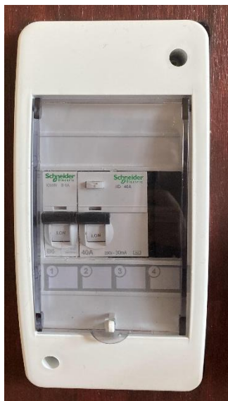
Obr.52: Rozvaděč napájecí stanoviště
