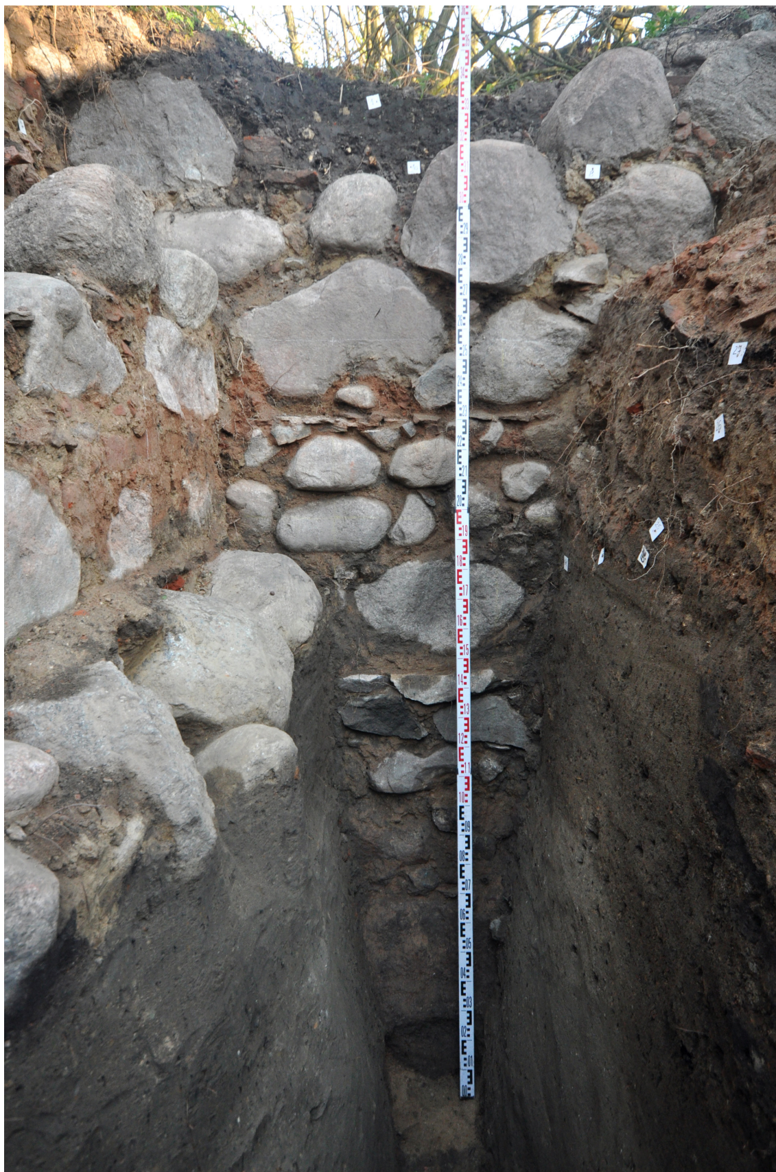
Obr. 10. Partia fundamentowa i cokołowa ściany domu konwentu odsłonięta w wykopie nr 1. Fot. B. Wasik. – Abb. 10. Die in der Sonde Nr. 1 entdeckte Fundament- und Sockelpartie des Konventshausesmauerwerks. Foto B. Wasik.
