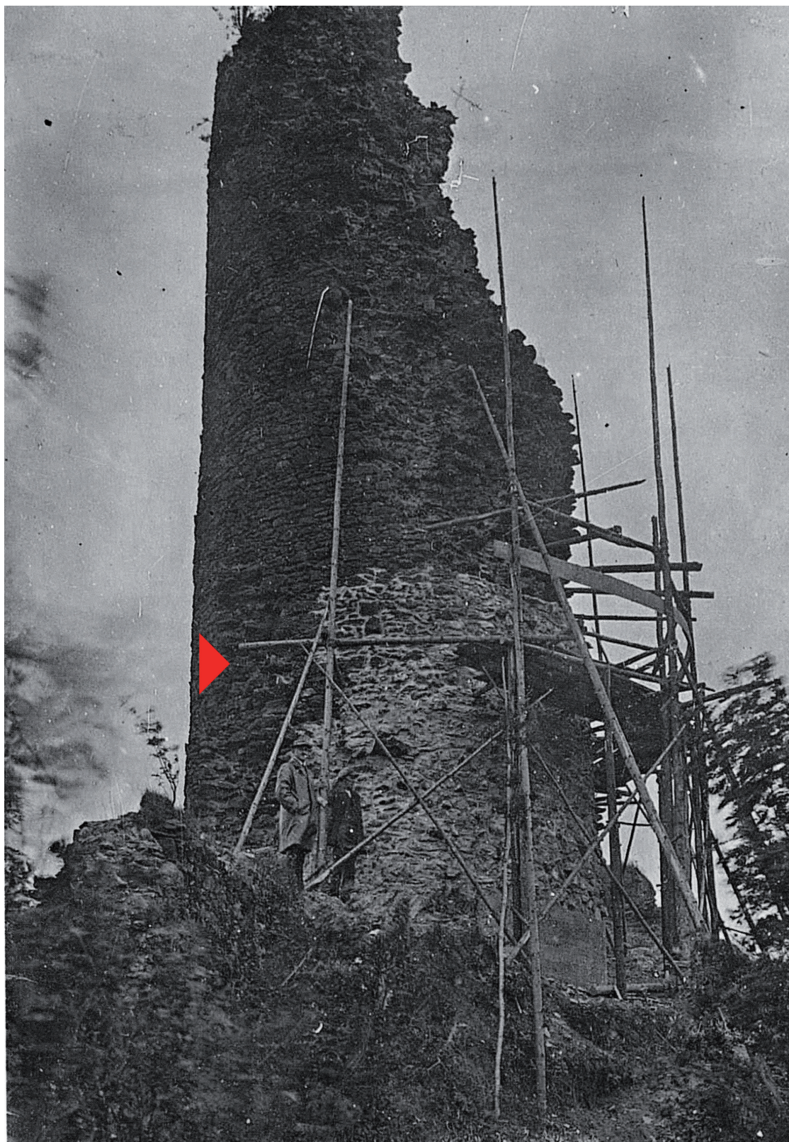
Obr. 6. Hrad Reichenstein (okr. Schwandorf). Stavební zajištění a stabilizace bergfritu v letech 1926–1929. Na snímku patrná jizva v plášti bergfritu po destruovaném zdivu přilehlé budovy, jehož fragment je dochován ve spodní partii (Archiv spolku Heimatkundlicher Arbeitskreis Stadlern). – Abb. 6. Die Burg Reichenstein (Bez. Schwandorf). Bausicherung und Stabilisierung des Bergfriedsmantels in den Jahren 1926–1929. Sichtbar sind die Spuren des ehemaligen Gebäudes, dessen Fragmente sind in den niedrigen Partien erhalten (Archiv des Heimatkundlichen Arbeitskreises Stadlern).
