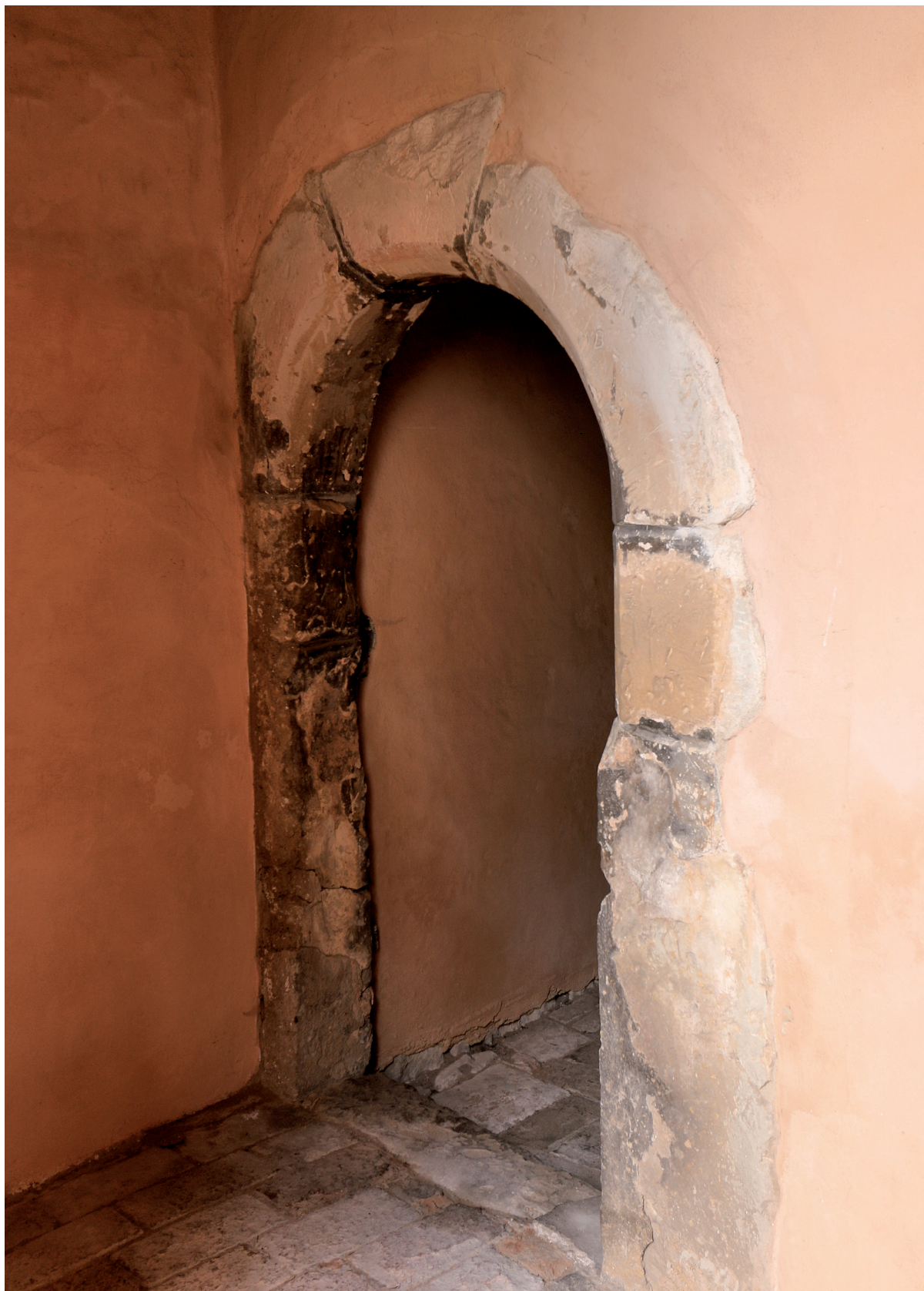
Obr. 16. Nový Hrad u Jimlína. Portál vedoucí z nádvoří do „dolejší světnice“ v severní části východního křídla. Foto autor 2016. – Abb. 16. Nový Hrad bei Jimlín. Vom Hof in die „untere Stube“ im Nordteil des Ostflügels führendes Portal. Foto Autor 2016.
