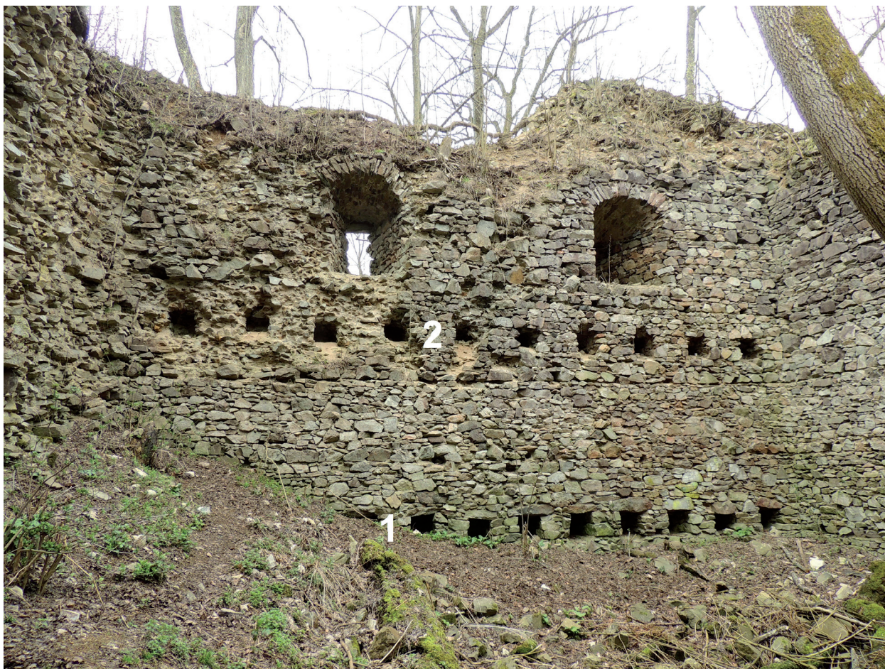
Obr. 5. Nový Herštejn. Rozdílné stavební provedení otvorů pro uložení stropních trámů mezi prvním a druhým podlažím (č. 1) a mezi druhým a třetím podlažím (č. 2) ve východní zdi donjonu. Foto a úprava P. Kastl. – Abb. 5. Nový Herštejn. Unterschiedliche bauliche Ausführung der Deckenbalkenlöcher zwischen dem Erdgeschoss und dem ersten Stock (1) und zwischen dem ersten und zweiten Stock (2) an der Ostwand des Donjons. Foto und Bearbeitung P. Kastl.
