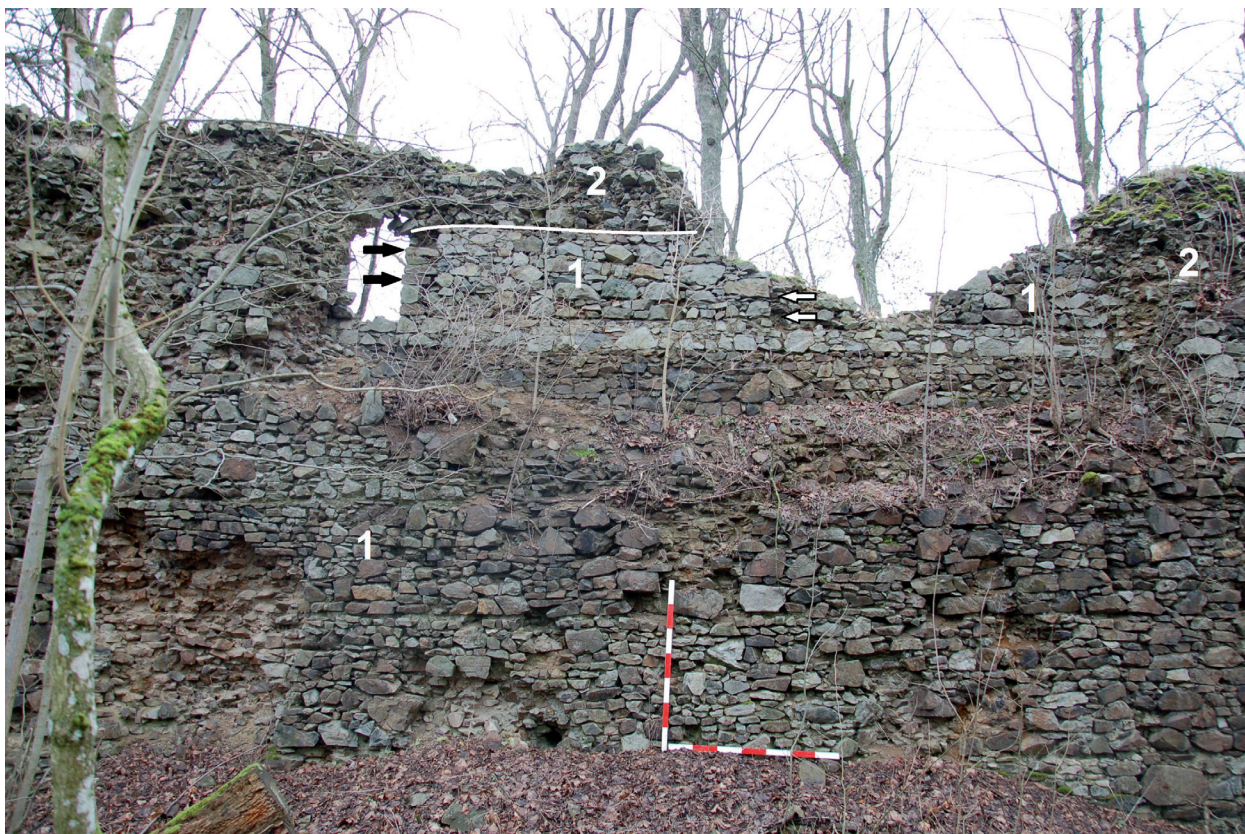
Obr. 11. Nový Herštejn. Nádvoří strana severní obvodové hradby s destrukcí nadezděné části, která odhalila původní stínku. Hrana stínky označena šipkami. 1- původní zdivo z poloviny 14. stol., 2- zdivo z konce 15. stol. Lať 1,4 m. Foto a úprava P. Kastl. – Abb. 11. Nový Herštejn. Hofseite der nördlichen Ringmauer mit Destruktion eines aufgemauerten Teils, welche eine ursprüngliche Zinne freigelegt hat. Der Rand der Zinne ist mit Pfeilen markiert. 1-ursprüngliches Mauerwerk aus der Mitte des 14. Jahrhunderts, 2-Mauerwerk aus dem Ende des 15. Jahrhunderts. Latte 1,4 m. Foto und Bearbeitung P. Kastl.
