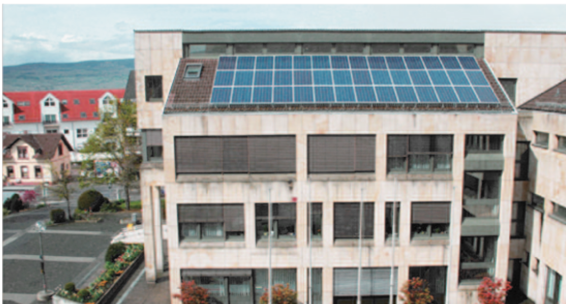
Photovoltaikanlage auf dem Rathausdach
