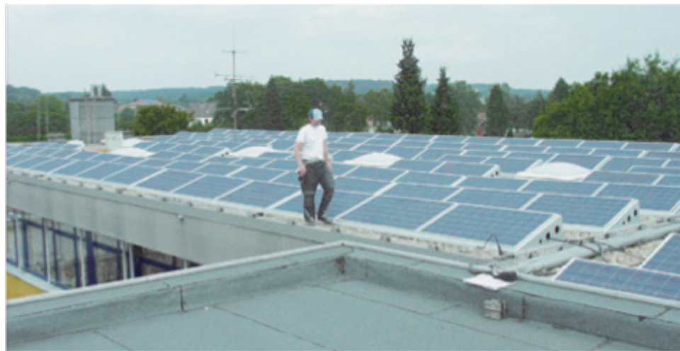
Photovoltaikanlage auf der Glückaufhalle
