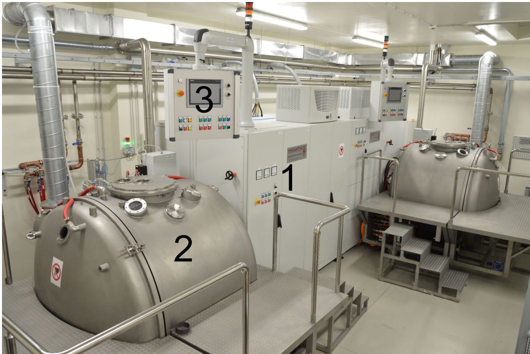
Obr. 4.5: Pohled na indukční systém IS-1 (v popředí). 1 – vysokofrekvenční elektronkový generátor, 2 – pracovní komora vybavená polohovacím systémem, 3 – ovládací panel.
