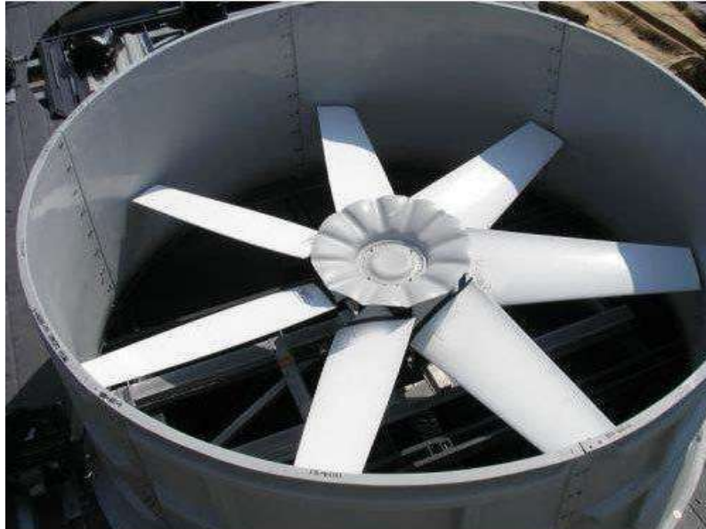
Obrázek 26: Ventilátor chladicí věže s plastovými lopatkami
