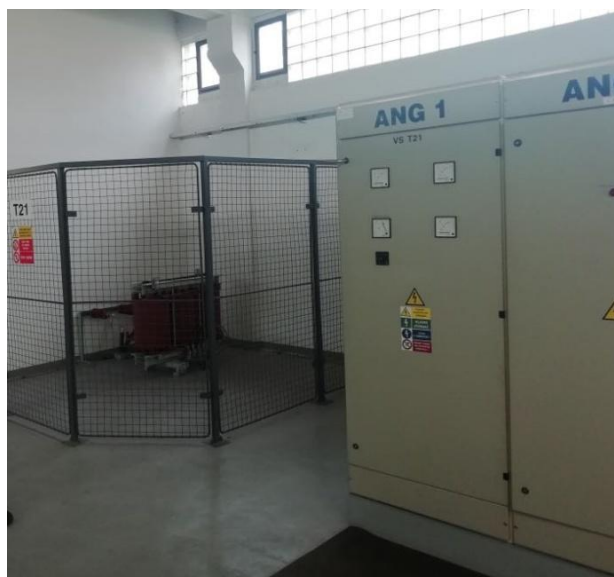
Obr. 12: Transformátor vlastní spotřeby a rozvaděč ANG
