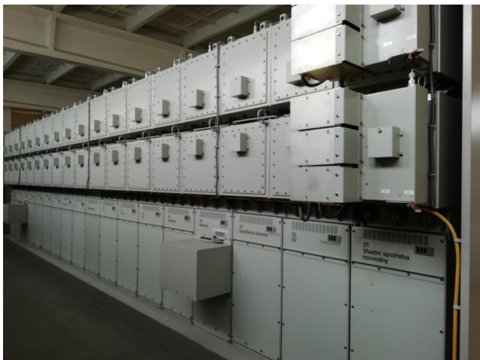
Obr. 11: Spínací stanice 22kV - pohled zezadu
