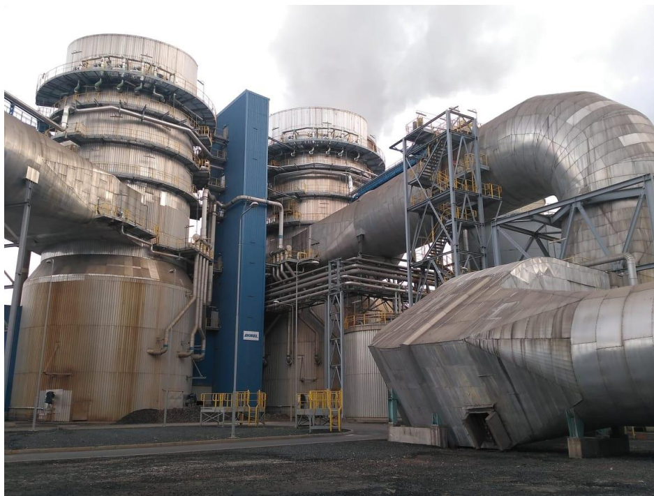
Obr.6 – Absorbéry s kouřovody tepelné elektrárny Tušimice II.
