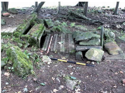
11, 12) Palebný objekt na severním okraji linie je poškozen, díky čemuž je vidět jeho konstrukce. Das Geschützobjekt am nördlichen Rand der Linie ist beschädigt, weshalb seine Konstruktion sichtbar ist.
