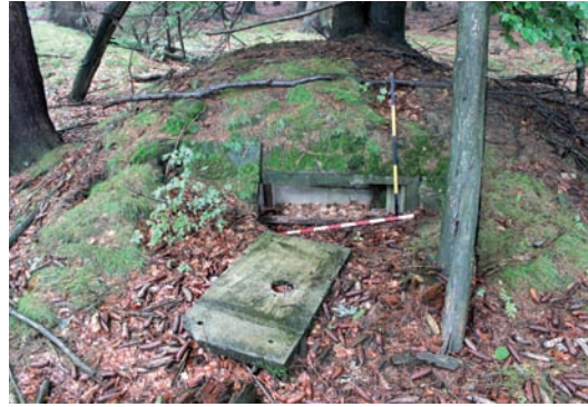
8) Palebný objekt z železobetonových prefabrikátů KŽ-1 pro těžký kulomet. Schützenobjekt aus Eisenbetonpräfabrikaten KŽ-1 für das schwere Maschinengewehr.
