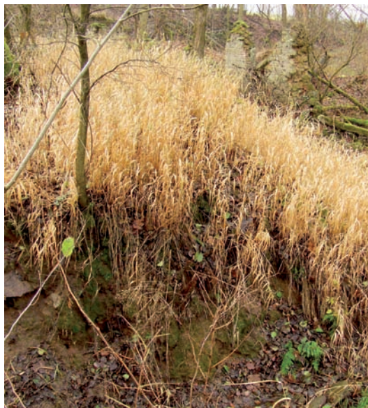
1) Mášův mlýn (okres Tachov). Pohled na porušenou hráz rybníka od severozápadu. V pozadí relikty vodního mlýna (pravý horní roh) (foto: L. Galusová 2007). Máša-Mühle (Kreis Tachau). Blick auf den beschädigten Teichdamm von Nordwest. Im Hintergrund: Relikte der Wassermühle (rechte obere Ecke) (Foto: L. Galusová 2007).
