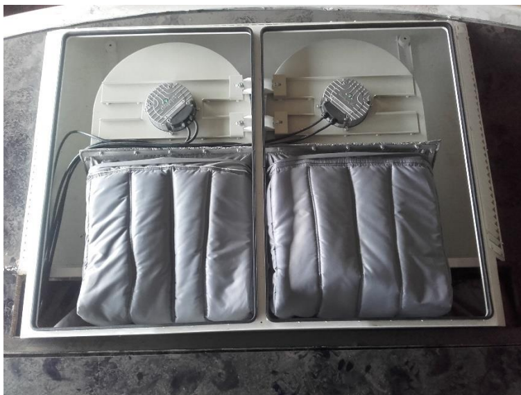
Obr. 211 Pohled do větrací jednotky na zaizolované lomené větrací kanály
