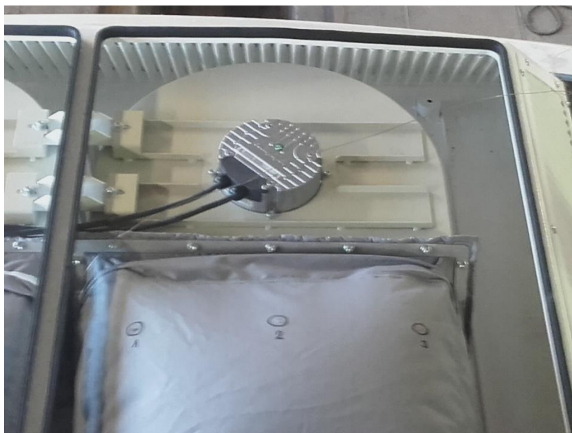
Obr. 92 Pohled na měřené místo v tkaninovém potrubí v oblasti připojovacího kanálu (za ventilátorem)
