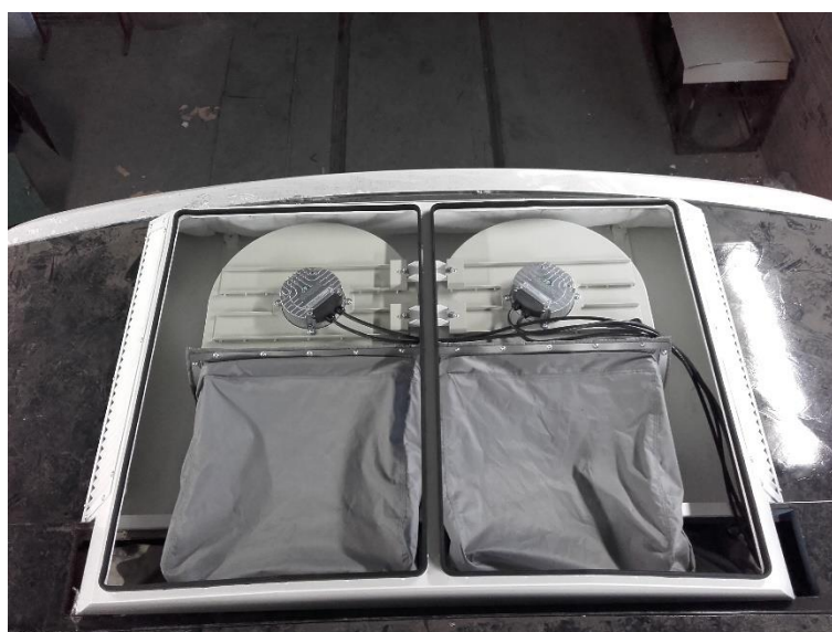
Obr. 210 Pohled do větrací jednotky na nezaizolované lomené kanály
