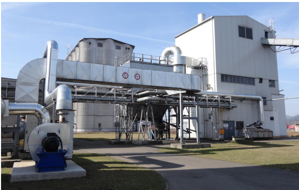
Obrázek 1: Kotel K4 včetně zařízení pro čištění spalin (foto autor)
